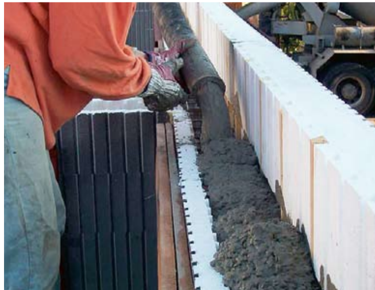
Stabilt. Frigolitmodulerna byggs på varandra som legobitar och är armerade med stål-galler. Sedan fylls de med betong vilket gör konstruktionen stabil. Foto: Euromac 2.
